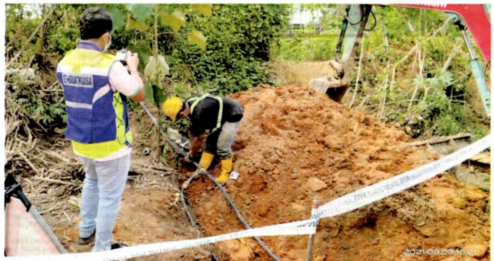
GAMBAR fall menunjukkan kakitangan SPAN menjalankan kerja-kerja pemotongan bekalan ke atas penyambungan haram dijalankan pihak tidak bertanggungjawab. – FACEBOOK SPAN
